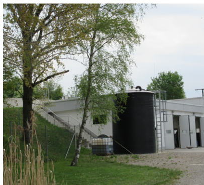
Abb. 6: Anlage mit Fällmitteltank
